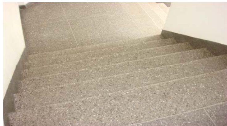
Foto N ° 2 Escalera sin material antideslizante y pintura reflectaría
