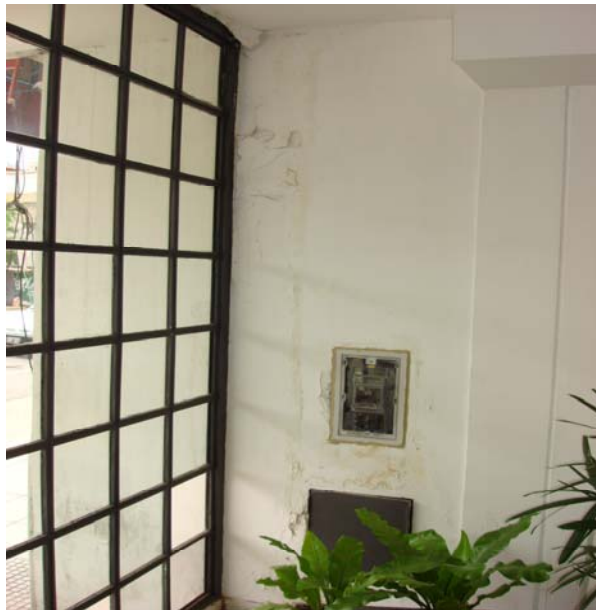
Foto Nº 10 Filtración material seco caja general de entrada de energía eléctrica
