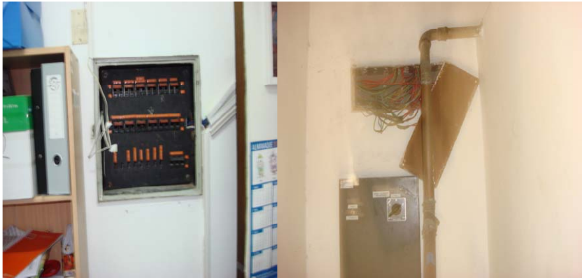
Foto N° 5 Tablero sin tapa de resguardo cables expuestos
