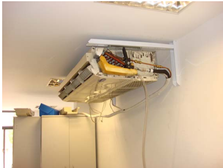
Foto N° 9 Equipo sin los elementos de protección
